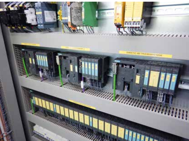
Steuerschränk: Hauptantriebs-, Kopierwerks- und Bremsensteuerung.
