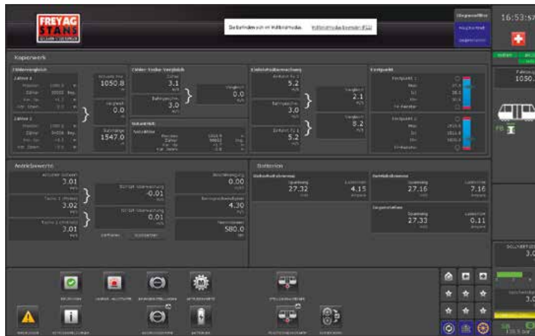
Bildschirm mit Visinfo in der Antriebsstation der Standseilbahn Stans-Kälti Foto: FREY AG STANS
