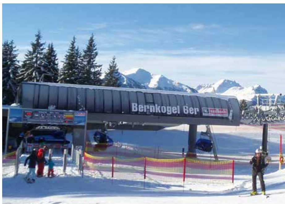
Hydraulische Spannstation im Tal.
