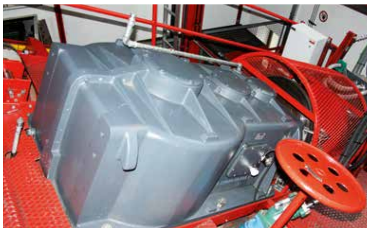
Der Antriebsmotor wurde von FREY Austria erneuert (s. auch S. 40).
