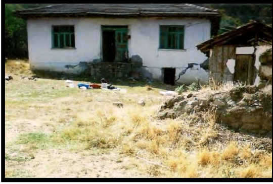
Foto 3. Hacıbey köyünde heyelandan zarar gördüğü için boşaltılan bir ev.
