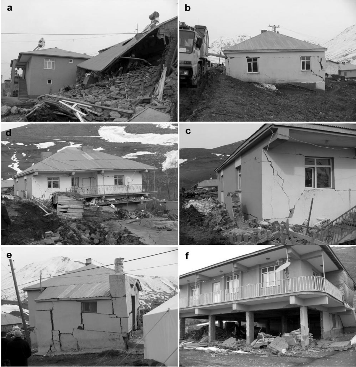
Foto 6: 8 Mart 2010 Kovancilar depreminde yüksek hasarlı betonarme binalar. a) Okçular'da hasarsız yapılar, b,c) Kayalık'da dikey kolonlarla desteklenmeyen yığma tuğladan yapılan 3 katlı meskenin ikinci katı ortadan kalkmıştır. e) Kayalık'da çok hasarlı bina, f) Yukarı Demirci köyünde dolgu üzerinde yapılan karkas binanın bodrum kat duvarları yıkılmıştır.
