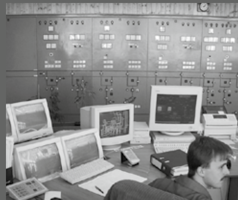
5. KÉP: A LITÉRI GT KEZELŐHELYE AZ ÁLLOMÁS VEZÉNYLŐJÉBEN
