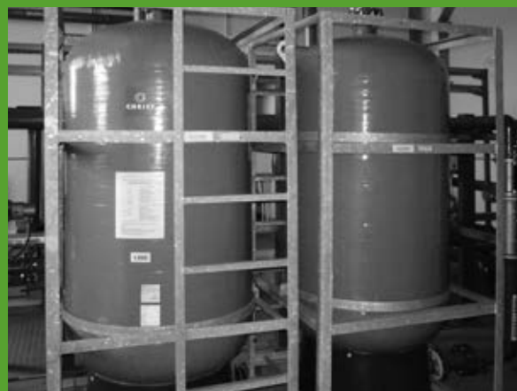
8. KÉP: SÓTALANVÍZ-TÁROLÓ TARTÁLYOK
