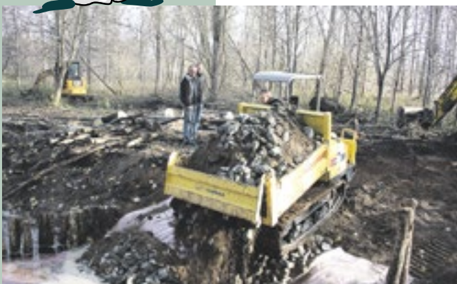
Wasserbau Karower Teiche mit Fischtreppe
