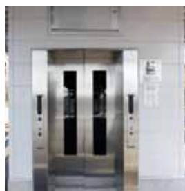
1 エレベーター
