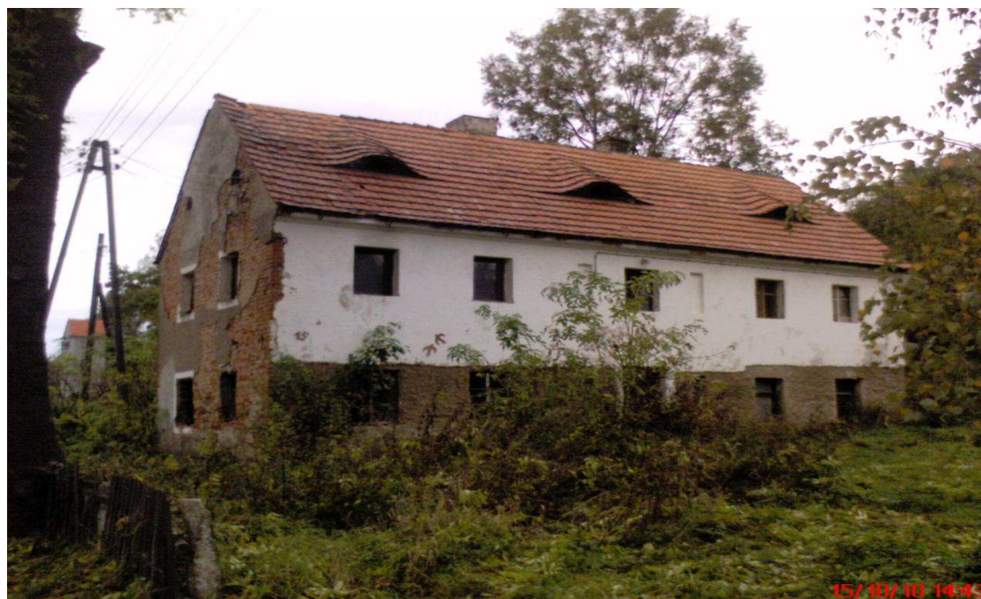
Zdjęcie nr 1. Winnica – opuszczony i niszczący budynek mieszkalny.
