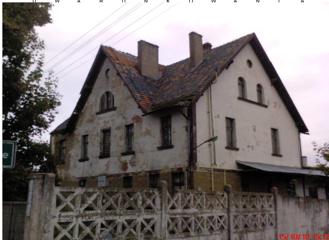
Zdjęcie nr 7. Wilczyce – opuszczony i niszczący budynek po byłej mleczarni.
