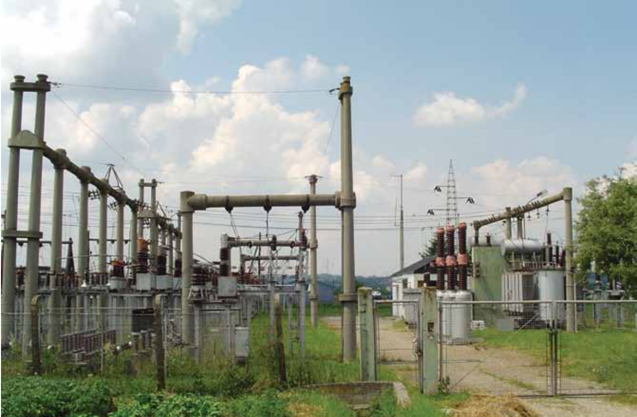
• Размењена трансформаторска станица у Илићеву
