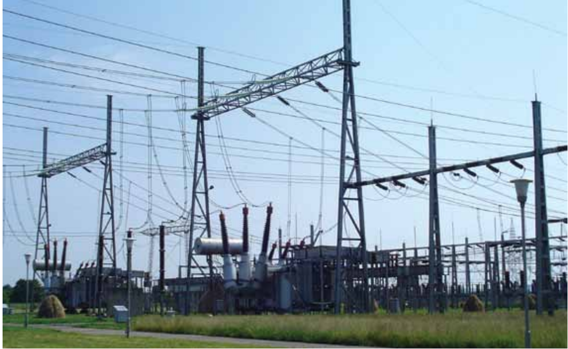
• Трансформаторска станица 400/100 kV – Крагујевац 2 – у Петровцу
