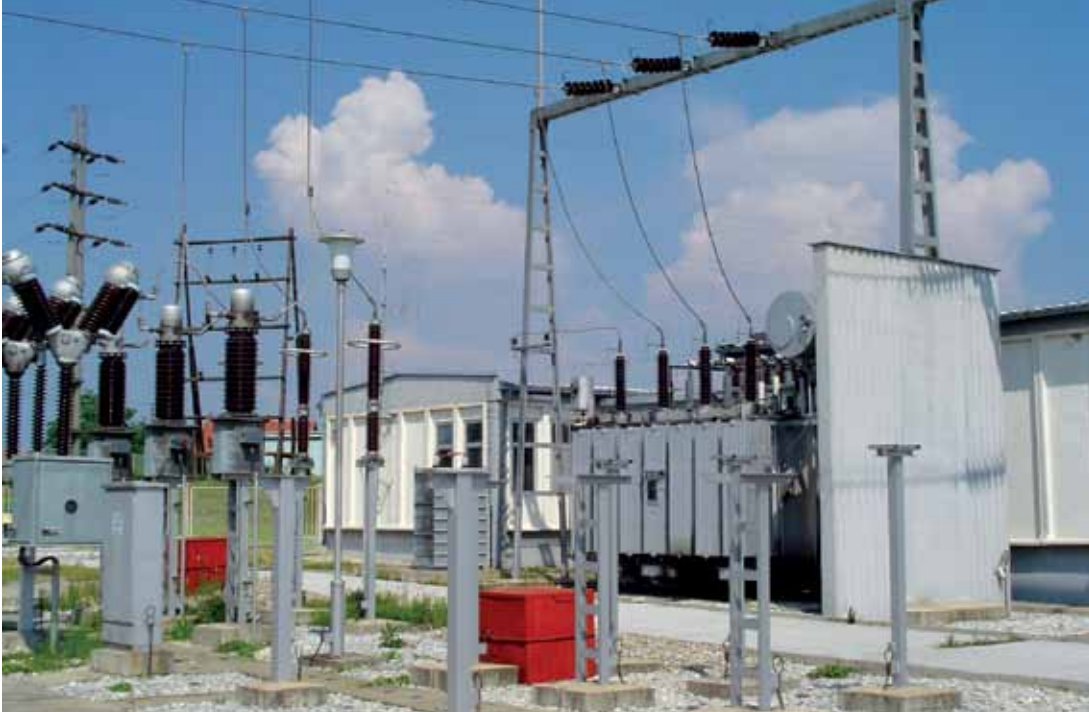
• Трансформаторска станица на Метином брду
