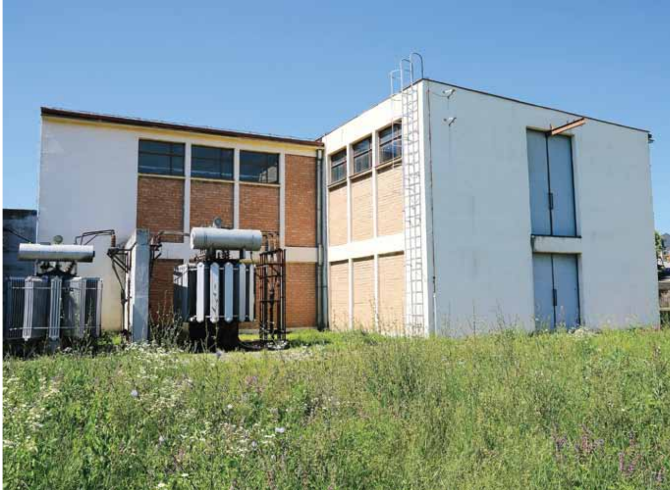
• Трансформаторска станица Становљанско поље - Крагујевац 01
