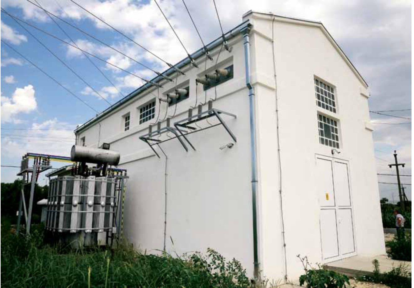
• Реконструисана трансформаторска станица 35 kV у Лапову
