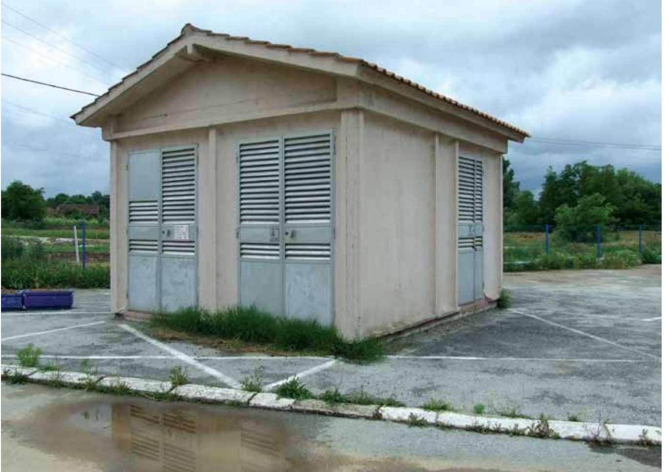
• Кондизаторско постројење у Рачи
