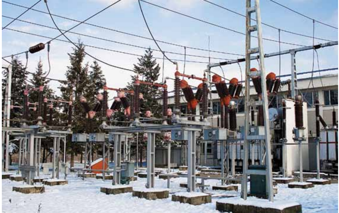
• Садашњи изглед трансформаторске станице код Чехословачког гробља
