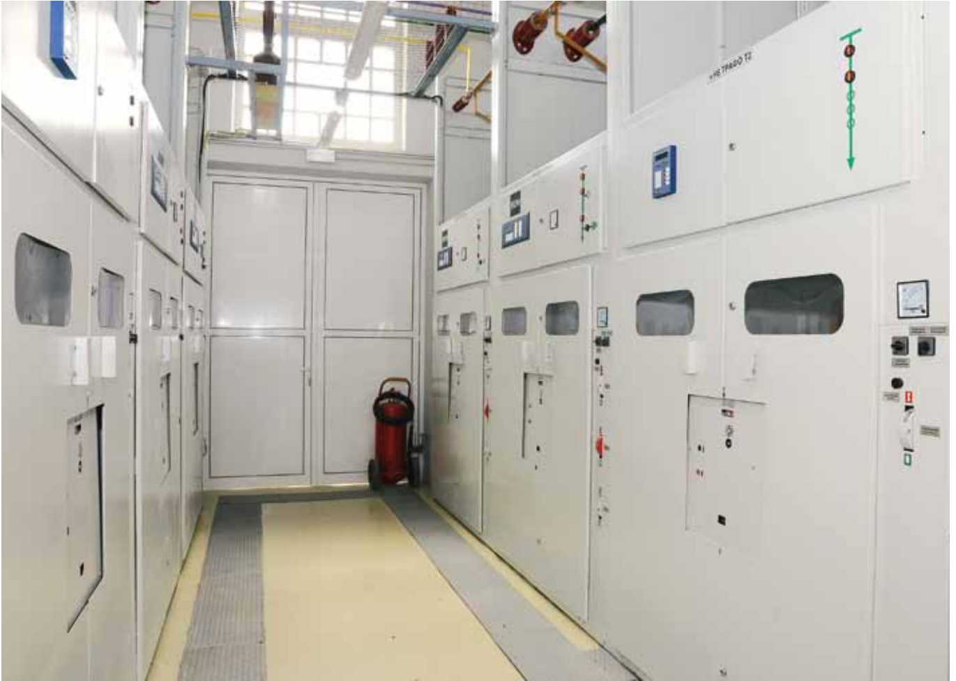
• Реконструисана трансформаторска станица 35/10 kV Лапово
