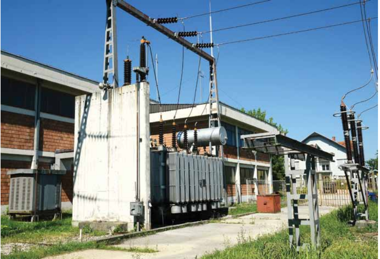
• Нова трансформаторска станица на Дивљем Пољу
