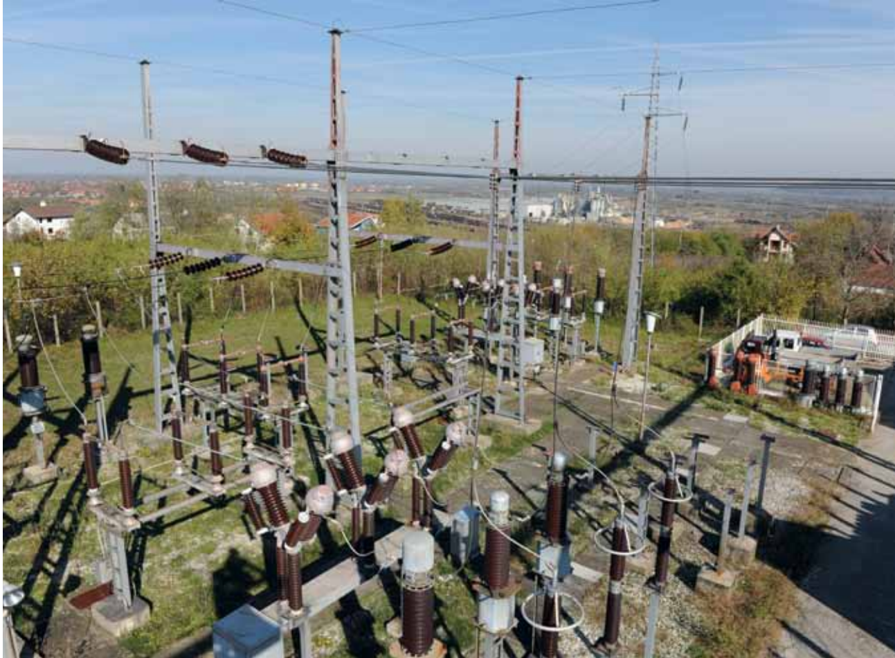
• Трансформаторска станица 110 kV, у Лапову
