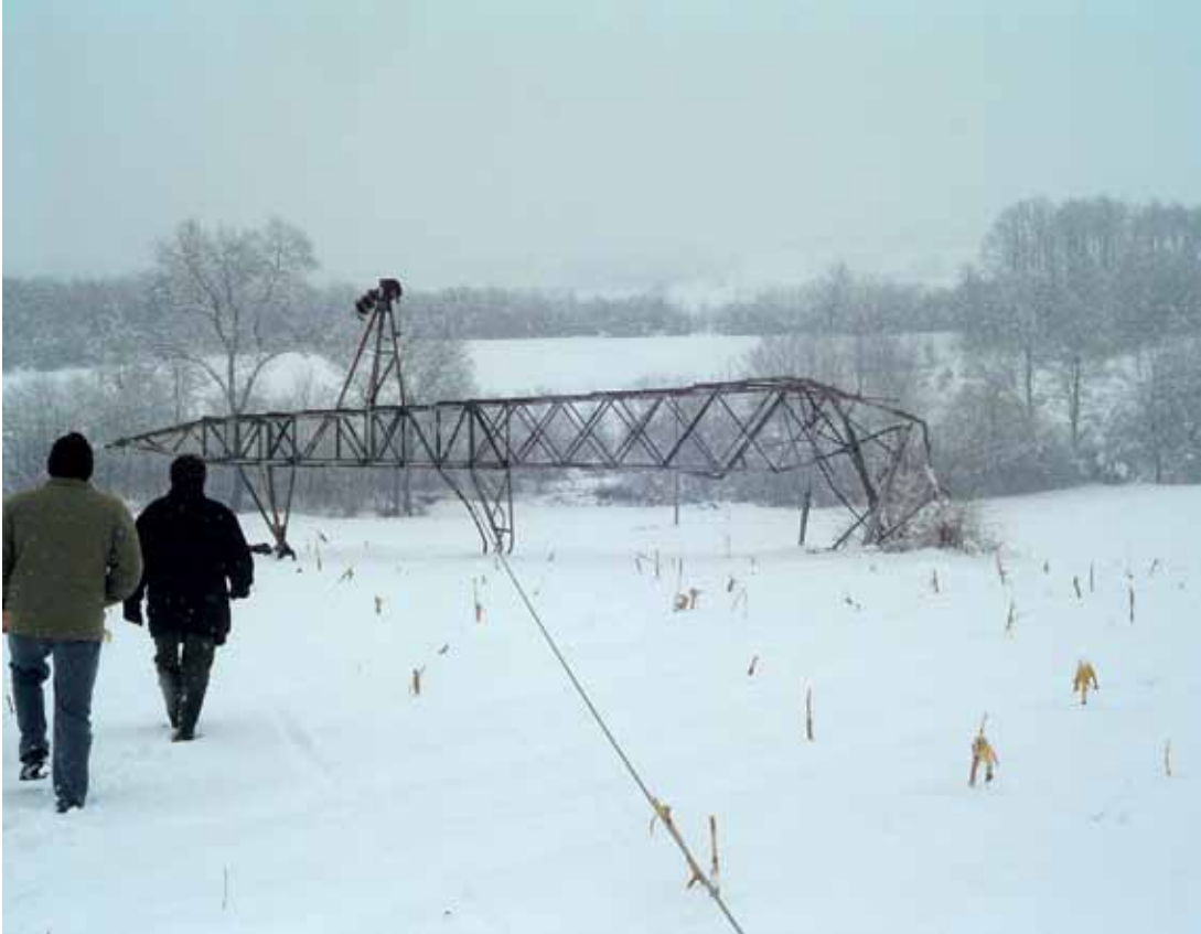
• Хаварија на далеководу 35 kV, Брзан – Баточина
