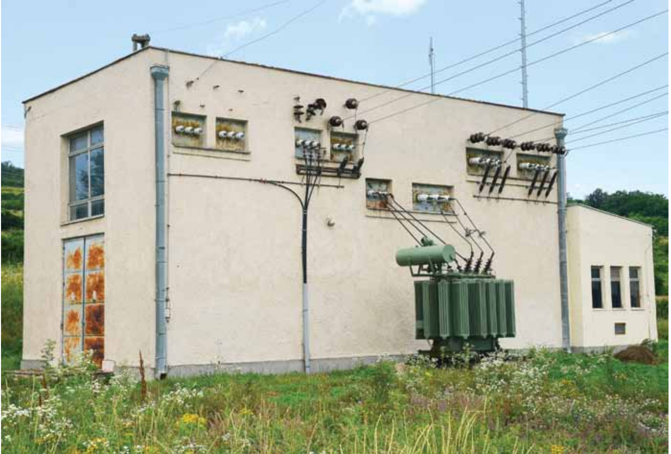
• Трансформаторска станица у Жировници за потребе водовода
