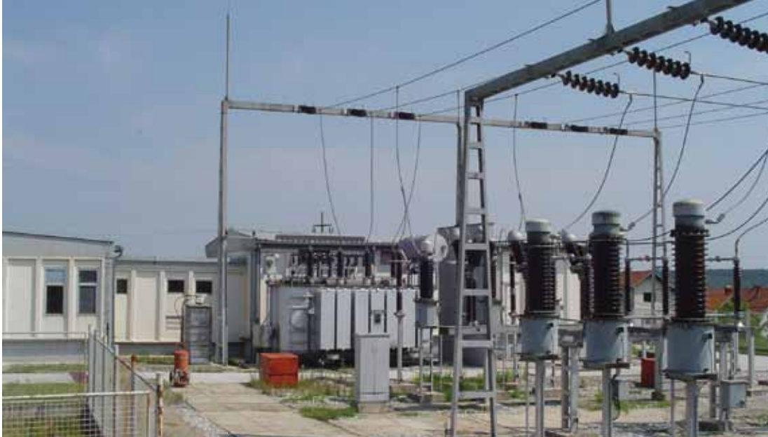
• Трансформаторска станица 110 kV на Метином брду
