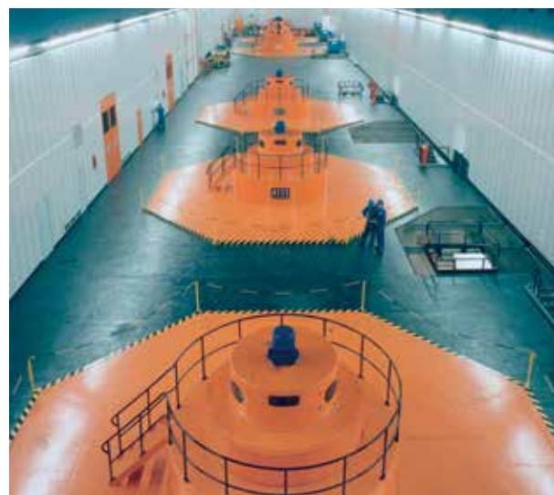
Salle des machines
