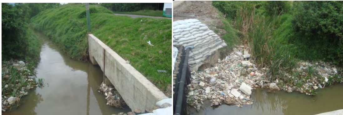
Imagen 100. Punto de muestreo P5, Canal de Torca calle 222, costado oriental de la autopista. 62
