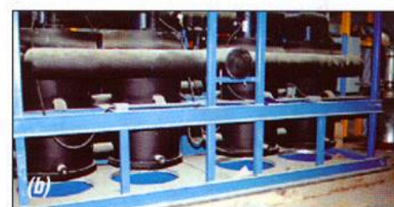
Рис 14. Большое административное здание холодоснабжаемое ледяной суспензией (а) и один из восьми 500-тонных генератор шуги (б)
