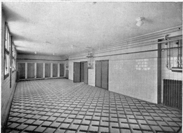
SALA DELLE DOCCIE. - Esse sono in numero di 12 disposte sui due lati corti della sala. - Da notare il gradino, dinnanzi le celle, contenente le tubazioni e coperto con lastre di marmo mobili, in modo che le ispezioni e riparazioni sono facili e rapide.
