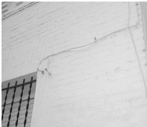
Entrada del cable de acometida en la calle pasaje de Doña Carlota.
