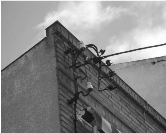
Palomillas en fachada de la calle pasaje de Doña Carlota.
