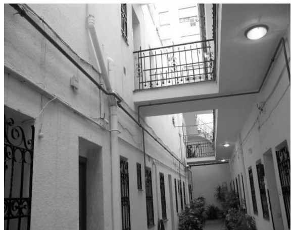
Detalle de la instalación de gas canalizado por el interior del patio.
