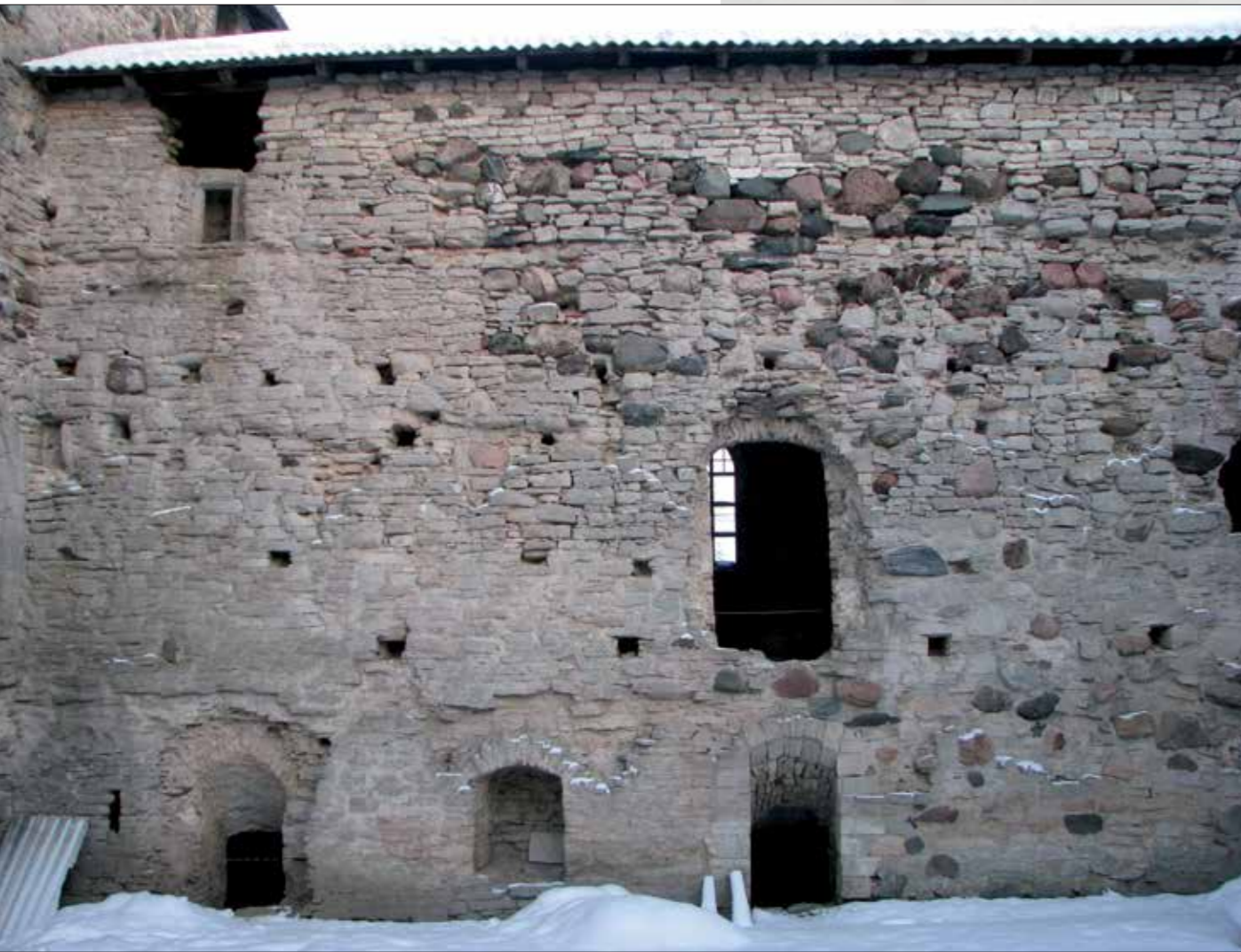
Kuva 29. Luostarin itäsiiven pihanpuoleinen julkisivu. Vasemmalta ylhäältä, sakariston ikkunan kohdalta kulkee rosoinen pystysauma oikealle alas kapitulisalin ja sen alapuolella olevan kellarin oviaukkoon asti (kuva: Villu Kadakas).
