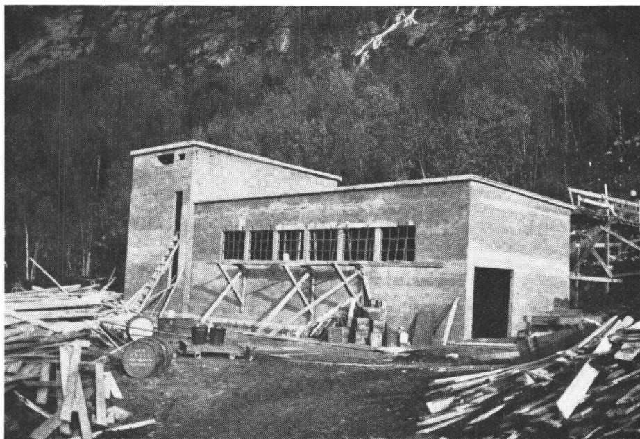
Kjærringøy kraftverk. Kraftstasjonen.
