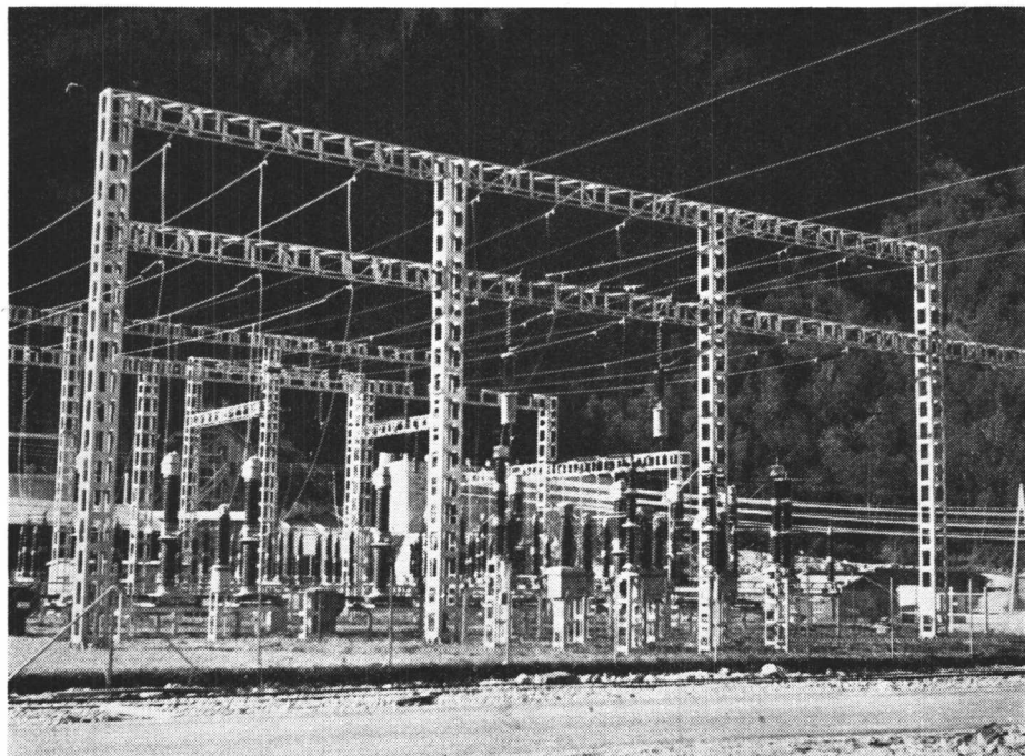
Aura kraftanlegg. 132 kV utendørsanlegg.
