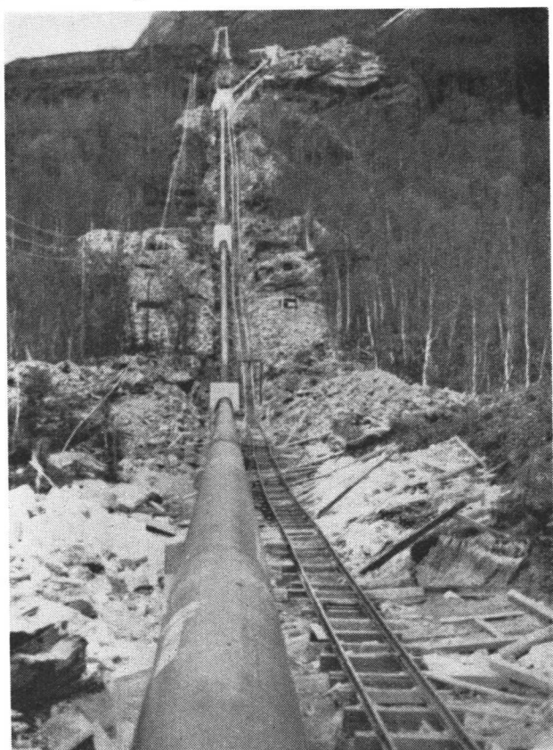
Niingen kraftverk. Del av turbinrørledningen.
