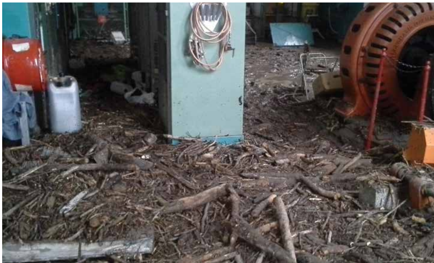
Poplavljen strojnica male hidroelektrarne Podmelec; foto: Arhiv SENG
