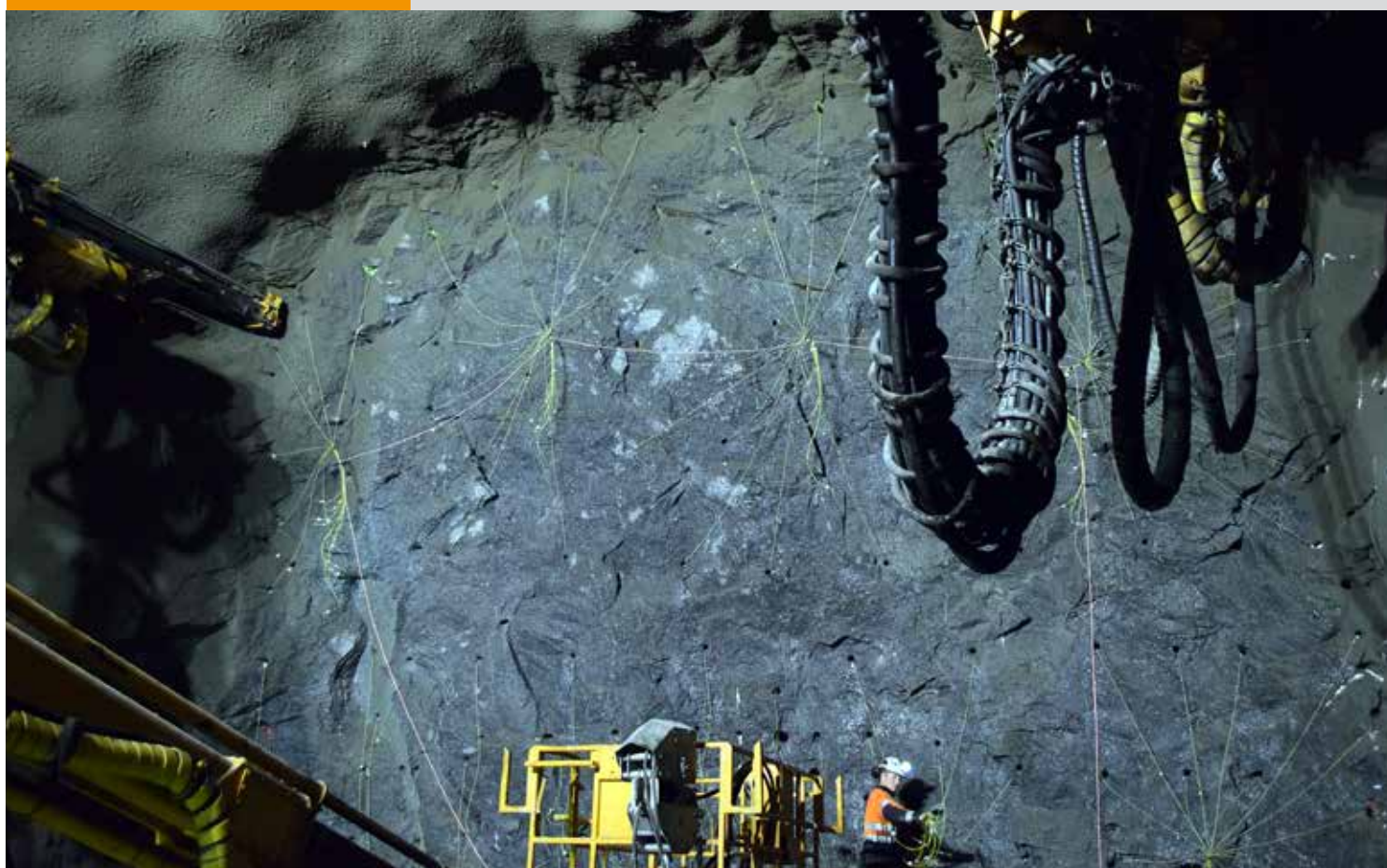
Her ser vi en ferdig ladet salve klar til sprenging. Det bores og lades ca. 150 hull, 5 meter inn for hver salve. Foto: Morten Thorbjørnsen
