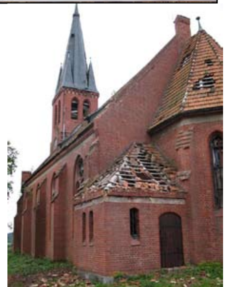
Die ehemalige evangelische Kirche in Pogutken, die seit Ende des 2. Weltkriegs ungenutzt ist, wurde durch den Wirbelsturm 2009 stark mitgenommen. Die Schäden, vor allem im Dach, sind noch immer zu sehen.
