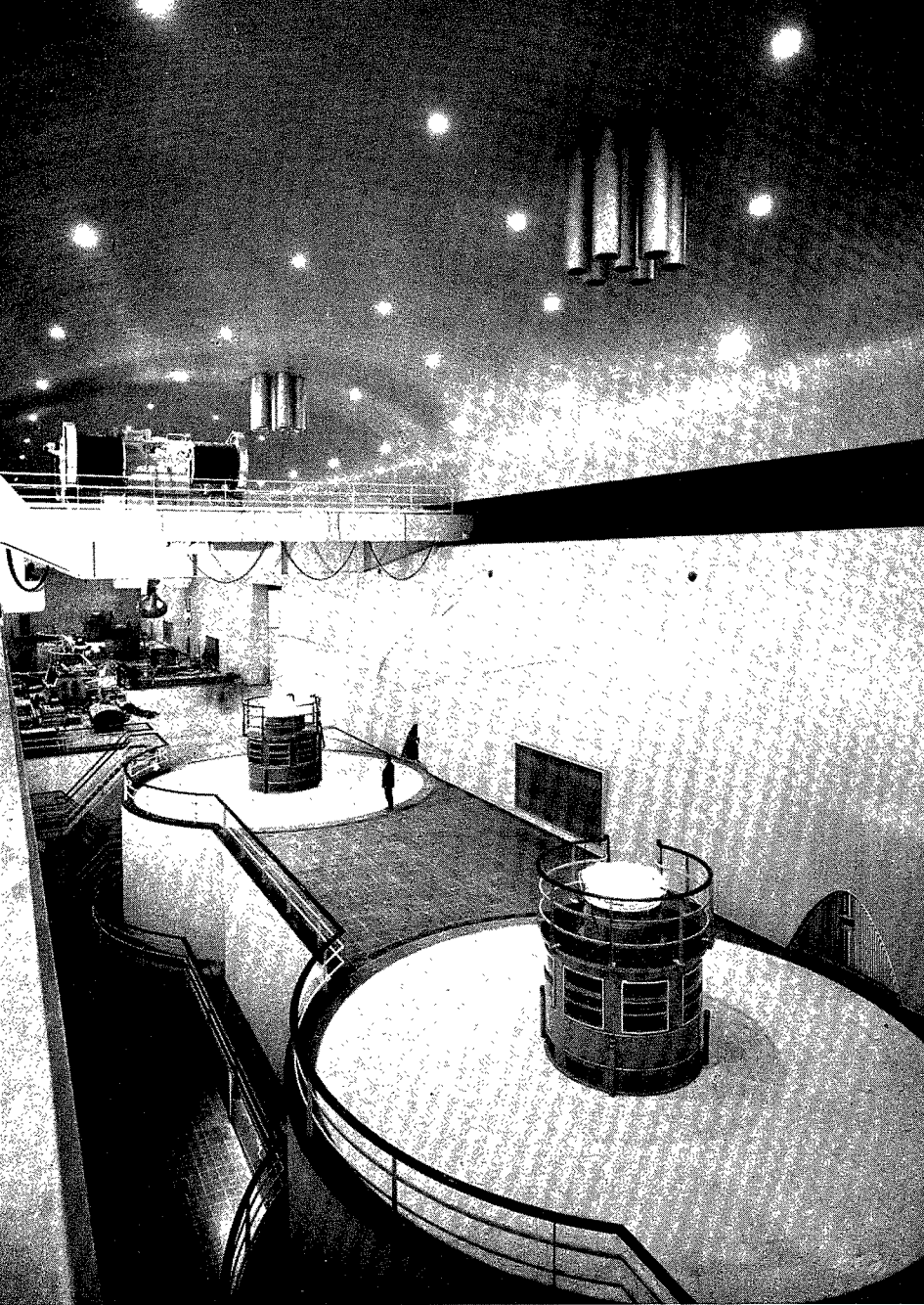
Salle des machines de l'usine souterraine de Serre-Ponçon.
