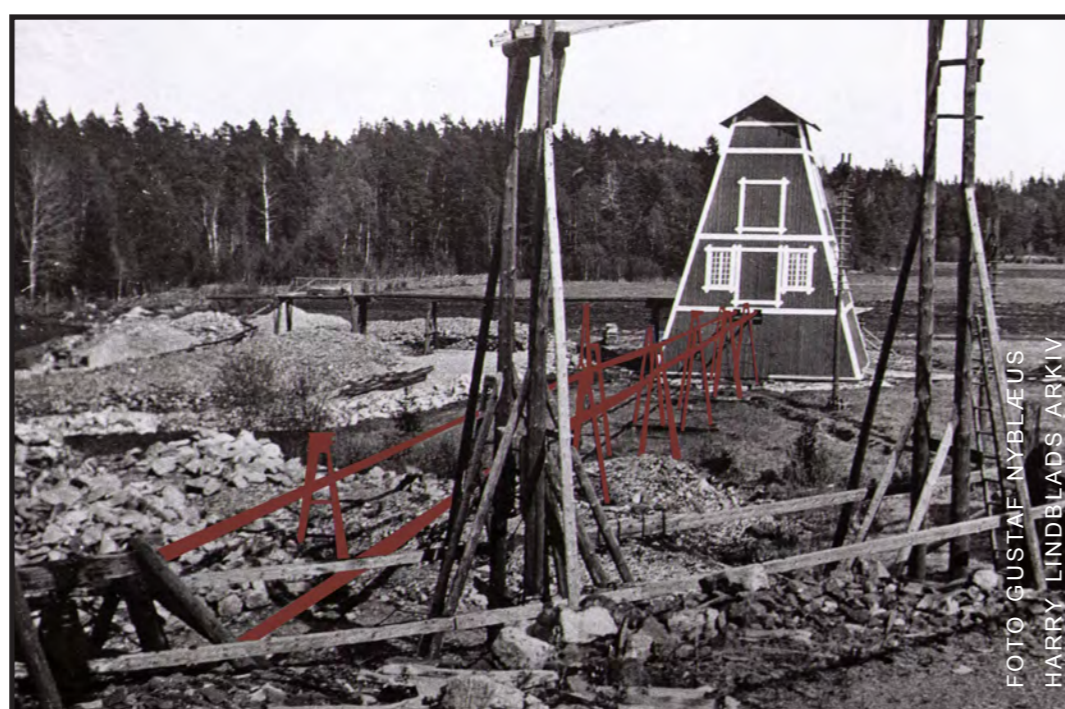
Gruvlaven vid Bredsjönäs, 1917. Stånggången som drev pumparna vid gruvan är rödmarkerad på fotot.
