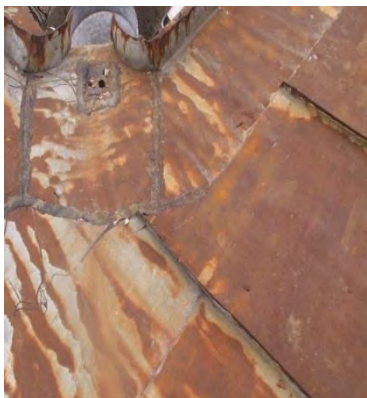
Аварийное состояние кровли ряда зданий, сооружений
