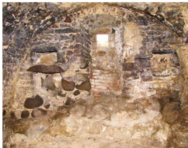
(2) Keskaegse keldriruumi raidkiviipiitadega aknaava ümbritsevad sümmeetriliselt paigutatud riulinišid ning ruumi kattev silindervõlv. Fotod Villu Kadakas
