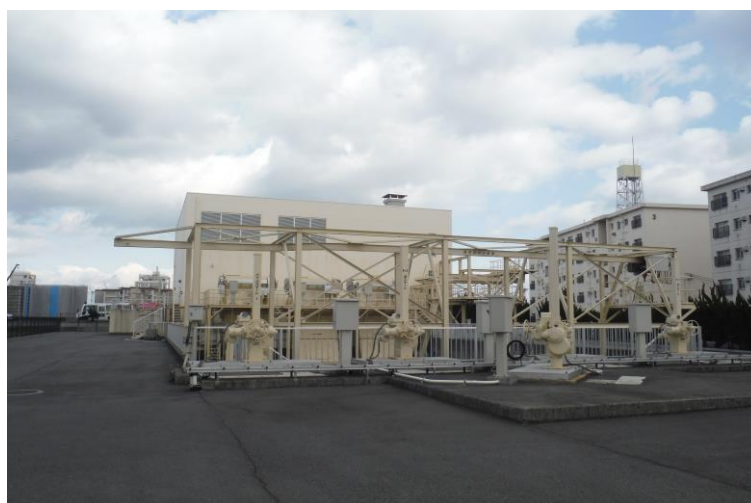
門前町排水機場
