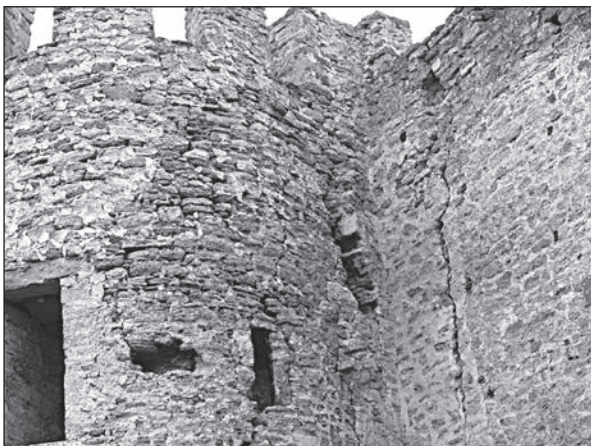
Рис. 3. Деталі руйнації башти № 25 (фото 2005 р.)
