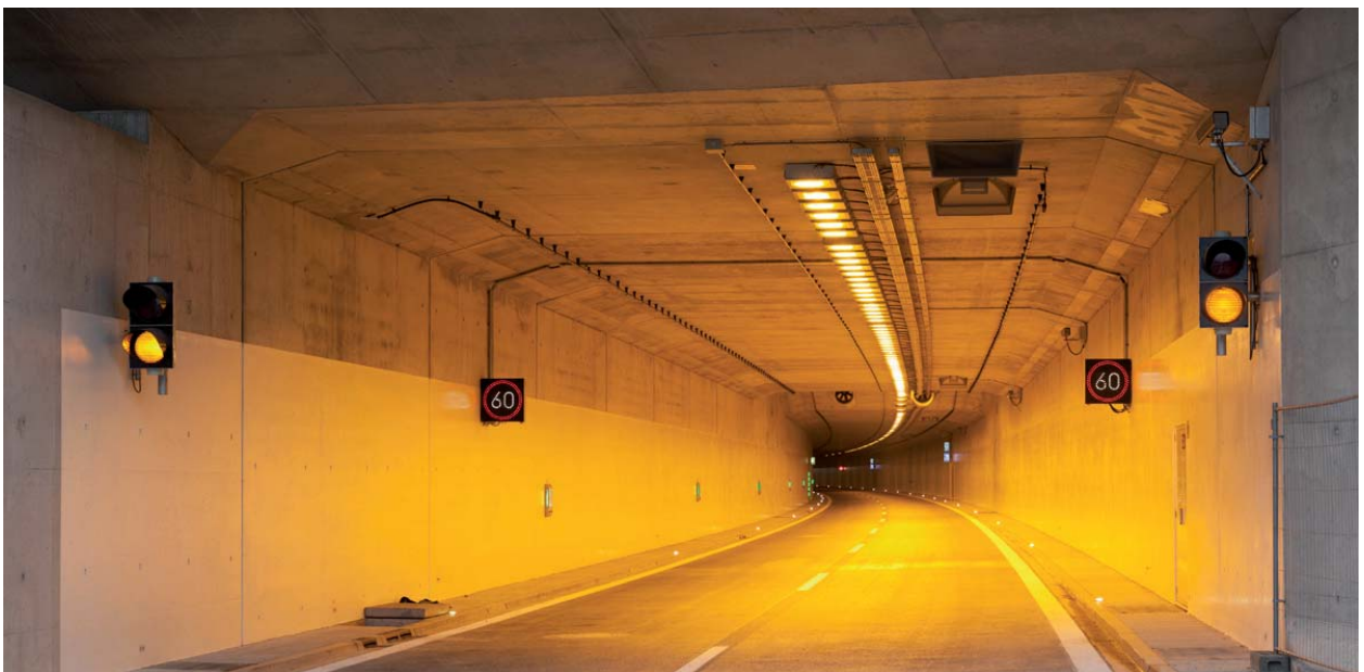
Wechselverkehrszeichen und Ampelanlage am Portaleingang
