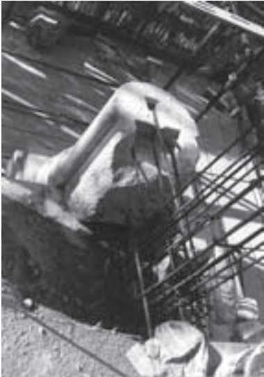
Particolare dell'aggancio di una colonna del terzo ordine alla struttura del telaio di consolidamento.
