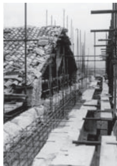
Corridoio all'altezza della trabeazione del secondo ordine con veduta del telaio di cemento armato in corso di realizzazione.
