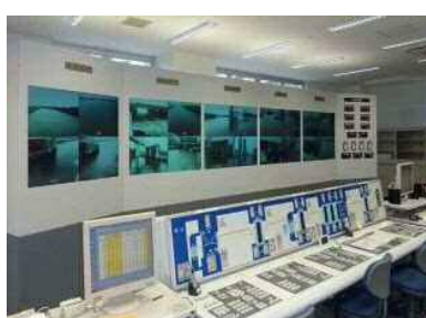
高潮対策センター（操作室）
