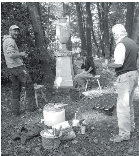
Foto zeigt das Grabmal Luckemeyer mit Bildhauer Bernd Bodechtel bei den Restaurierungsarbeiten.
