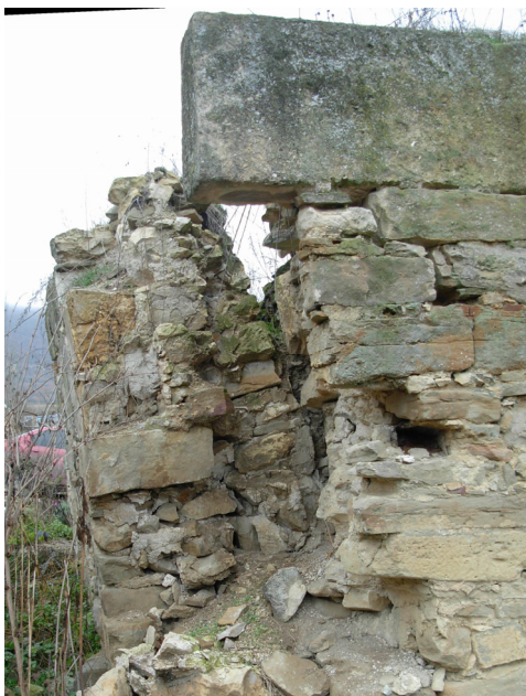
9. Церковь Сурб Саргис. Отошедшая западная стена
