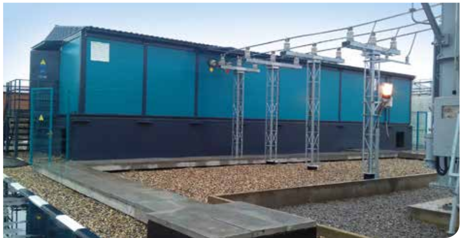
| РП-2 от ЗАО «Промэнерго» для ООО «Тепличный комбинат» г. Ярославля. Май 2016 г.
