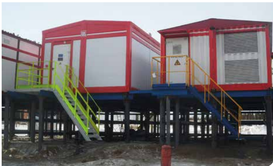
| Подстанция в тайге ООО «Лукойл-Коми». 2015 г.
