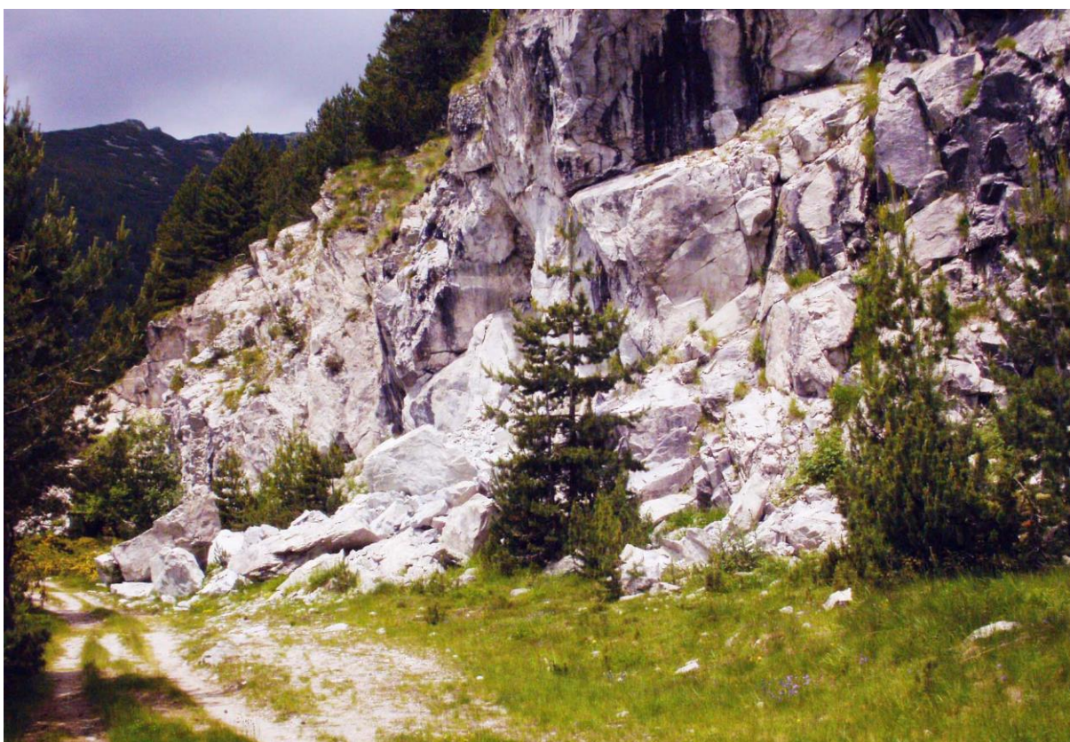
Фиг.1.19.-13. Антропогенно създаден откос и малко срутище при строителството на деривацията на кота 1900
