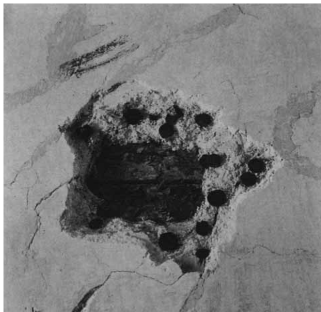
Predigerkirche. Verankerung des Stuckes an der Holz-Tonnendecke mit grossköpfigen Nägeln. Rund um die blossgelegte Stelle alt ausgeflickte Risse.
