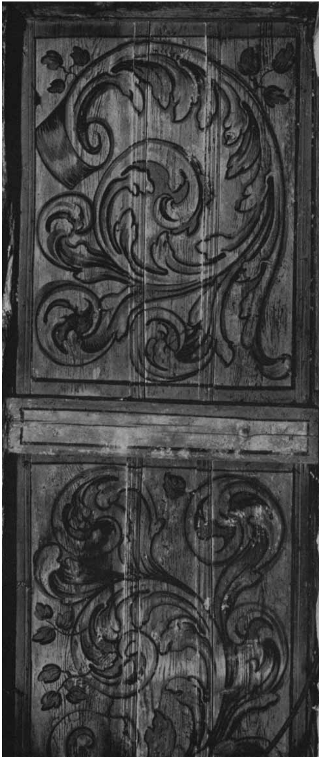
Wetzikon. Schloss. 2. Obergeschoss. Teile einer bemalten Balkendecke in der heutigen Küche. (Wieder übergipst.)
