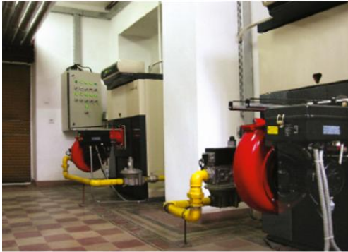
Sala Cazanelor din Facultatea de Inginerie a Instalațiilor
