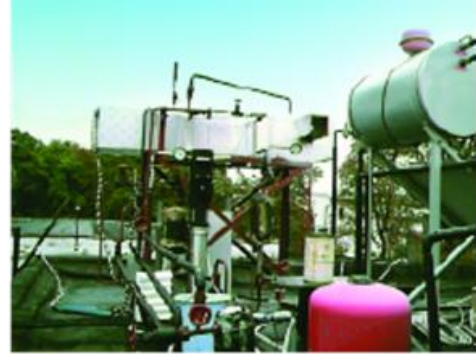
Instalație termică pentru utilizarea energiei solare
