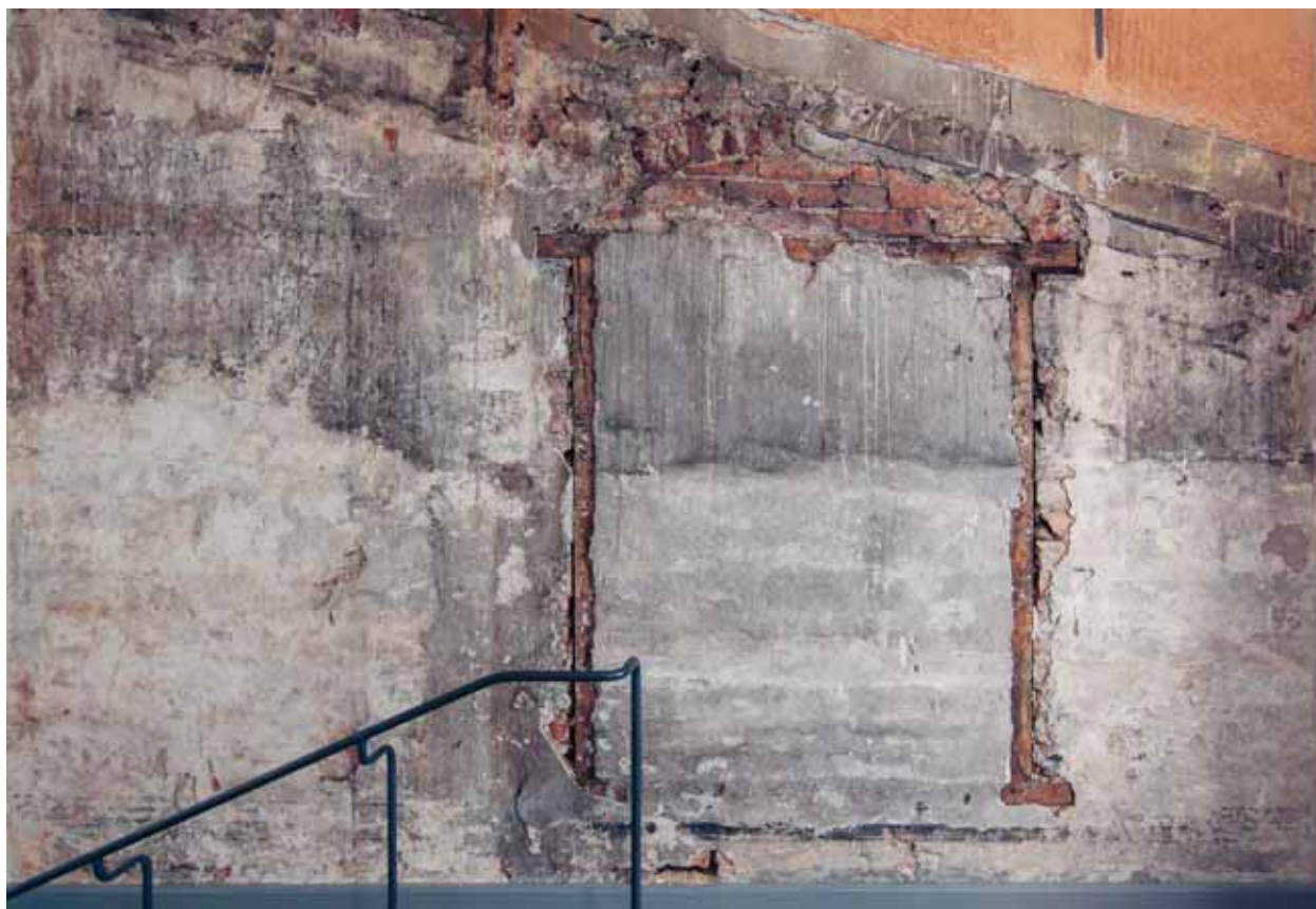
Igensatt fönster och originalputs i gaveln mot norr, inkorporerat i trapphuset mot Kammarrättens hus, foto 2011.
