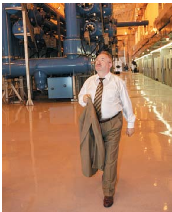
Открытие подстанции 500 кВ Западная в Красногорском районе Московской области в 2008 году
