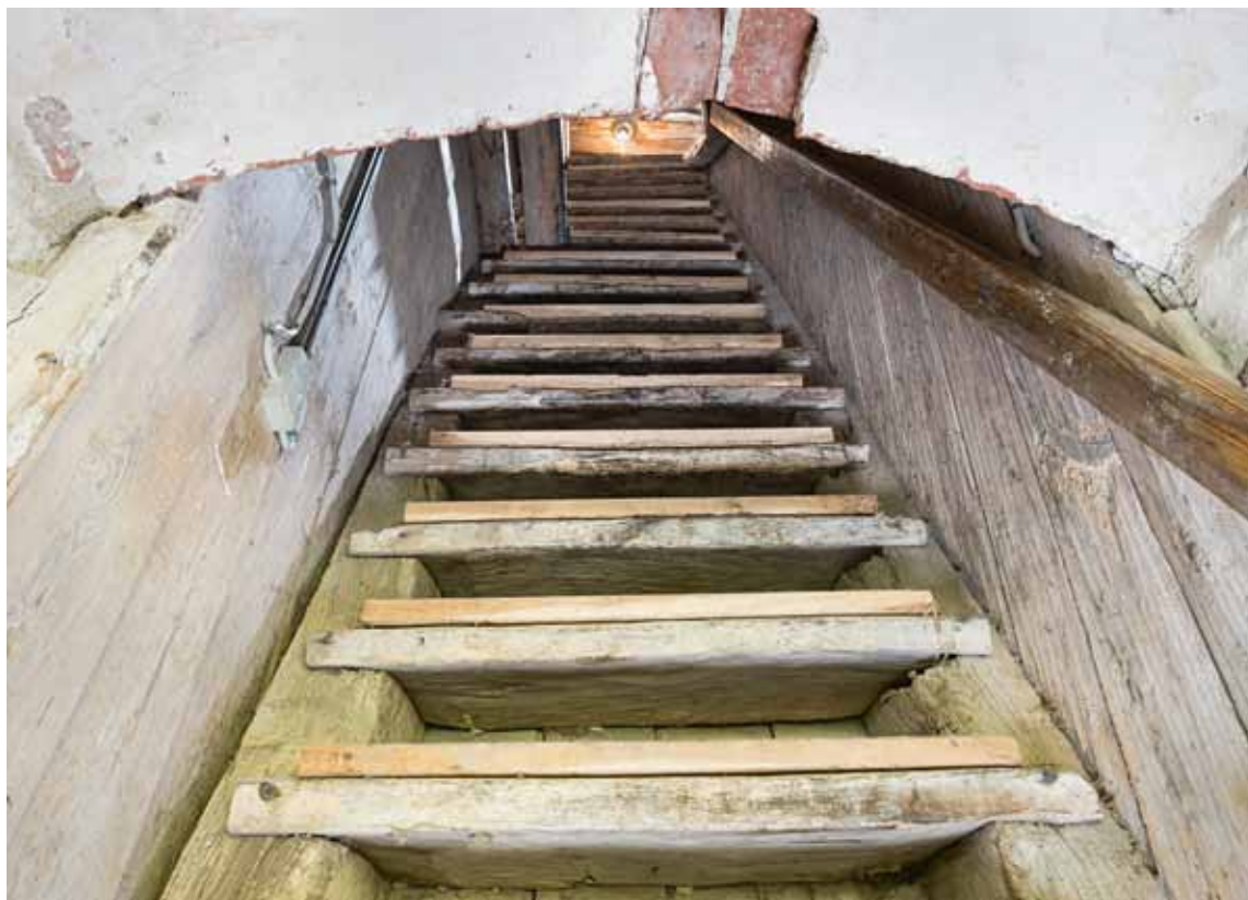
Fig. 51. Trappe til tårnets øvre stokværk set nedefra (s. 3666). Foto Arnold Mikkelsen 2015. – Stairs to upper storey of tower seen from below.
