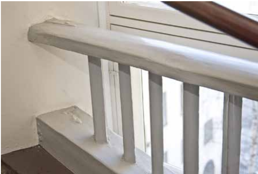
RÄCKE FRÅN 1700-TALET I GATHUSETS TRAPPA, MED RUNDAD ÖVERLIGGARE OCH SMIDDA INFÄSTNINGAR I VÄGGEN. FOTO: J. MALMBERG.
