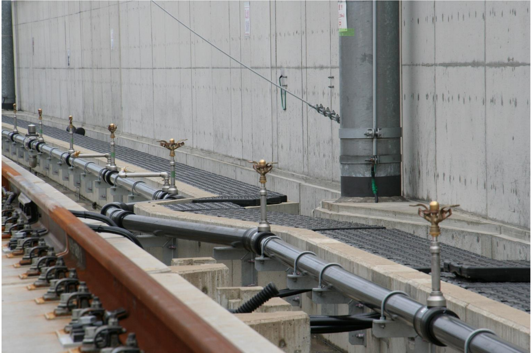
北海道新幹線に設置されたスプリンクラー
