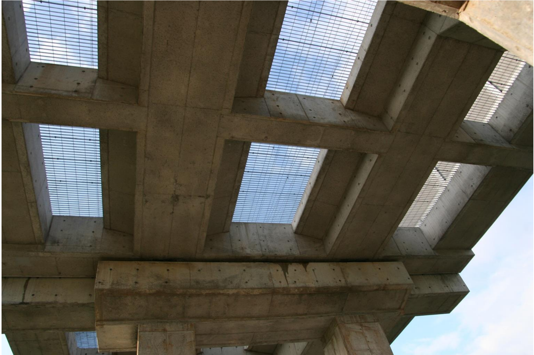
北海道新幹線に設置されたグレーチング
