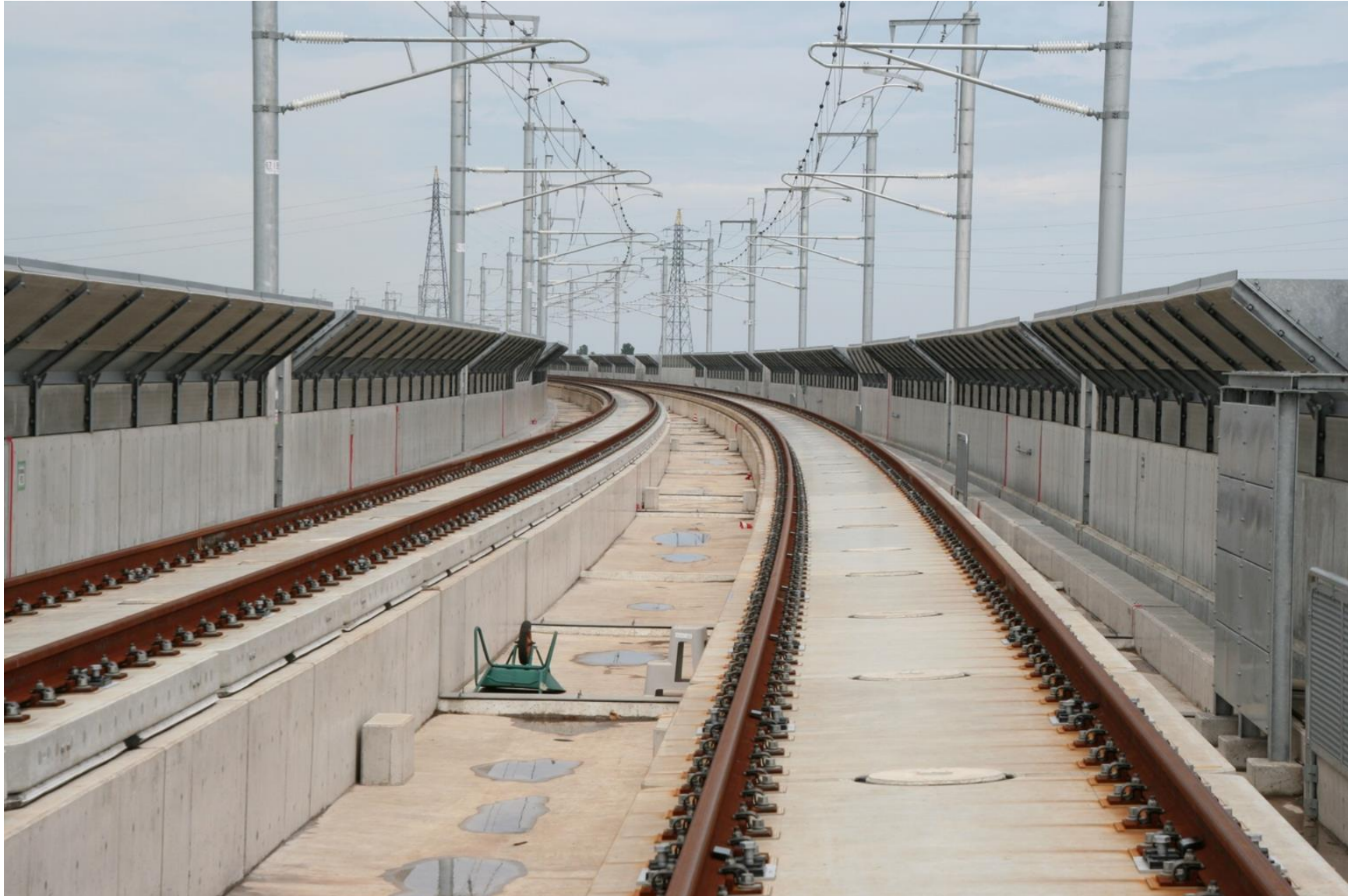
北海道新幹線に設置された貯雪式高架橋。線路はスラブ軌道
