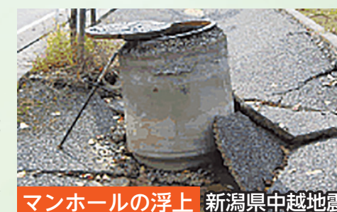
マンホールの浮上 新潟県中越地震
