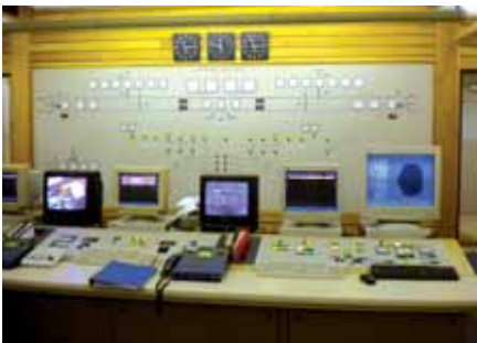
▲ Bestehende Leitstelle im PSPP Palmiet, Südafrika
