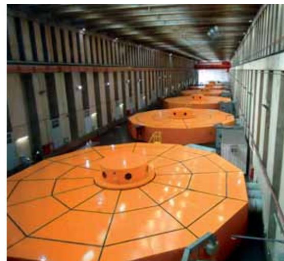
▲ Das Kraftwerk nach der Modernisierung
