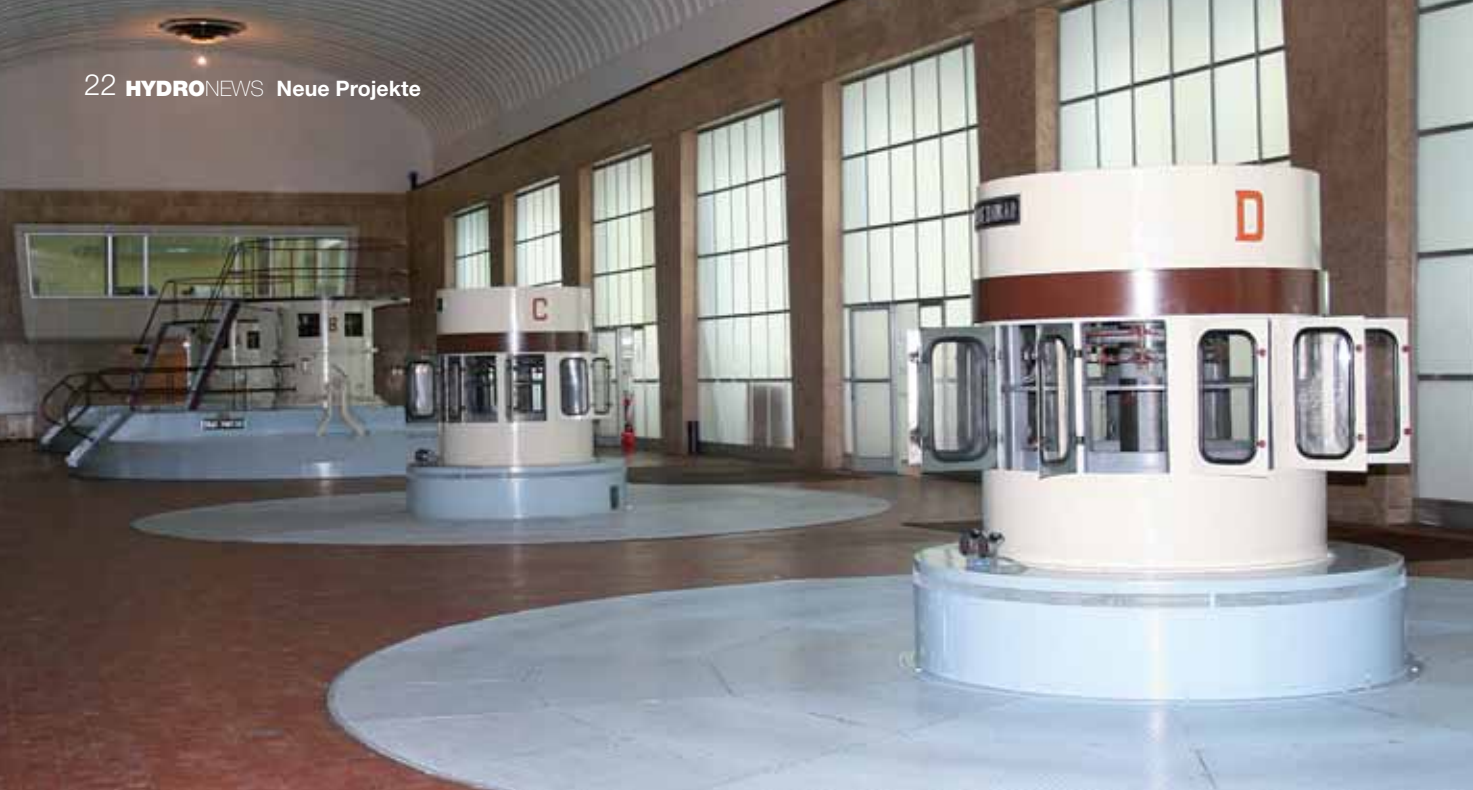
▲ Maschinenhaus des Wasserkraftwerks Vrutok, Mazedonien
