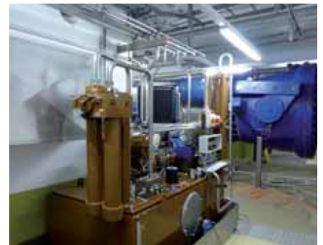
▲ Hydraulikaggregat nach Wiederaufbau
