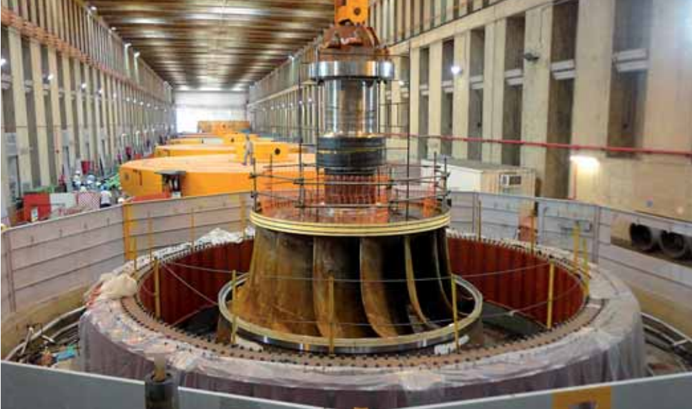
▲ Estreito Unit #4, Francis Laufrad
