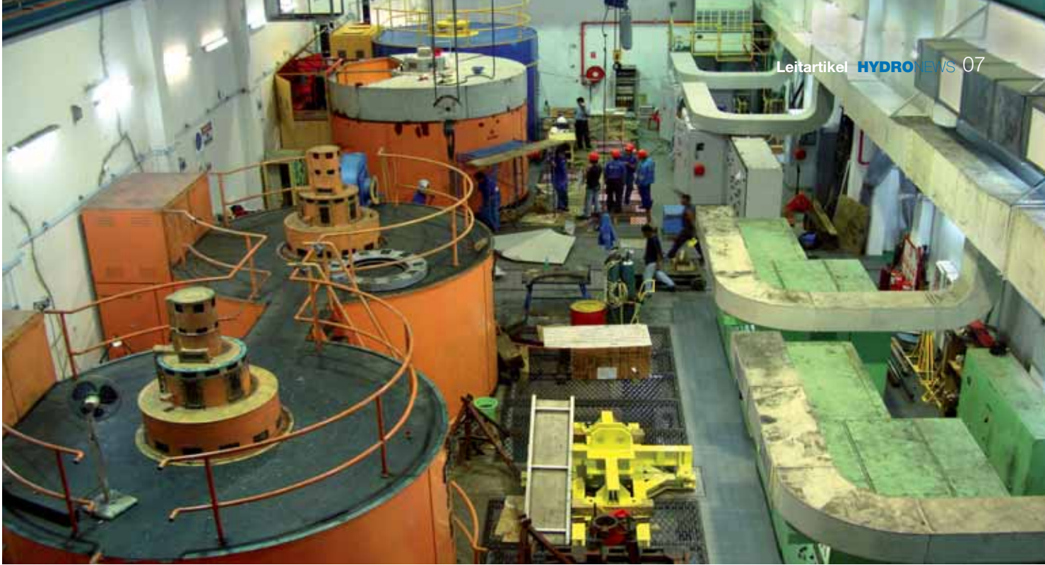
▲ Kaverne des Wasserkraftwerkes Rouna 2, in Papua-Neuguinea
