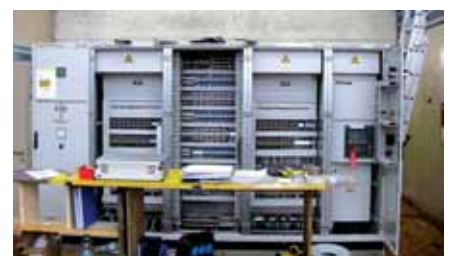
▲ Inbetriebnahme der Motorsteuerung (MCC)
