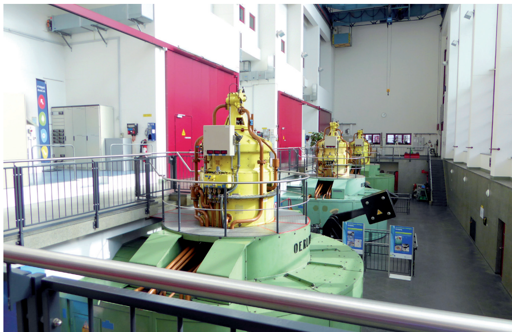
Bild 17: Maschinensaal mit 3 Escher-Wyss Vertikal-Kaplanturbinen
