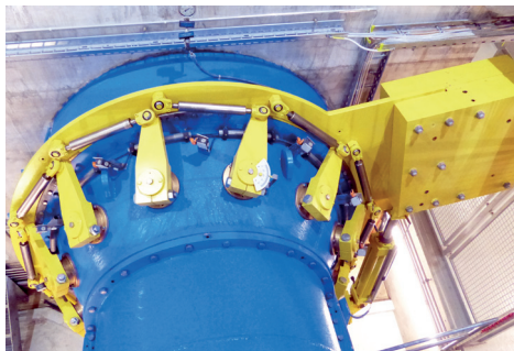
Bild 15: Leitapparat mit Schliessgewicht Dotier-KW
