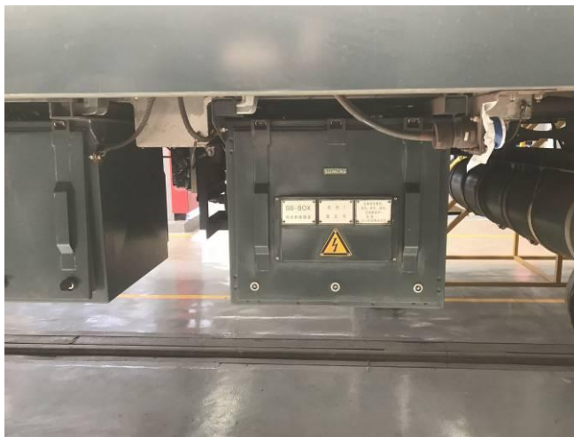
图 9.2-1 地铁列车蓄电池照片
