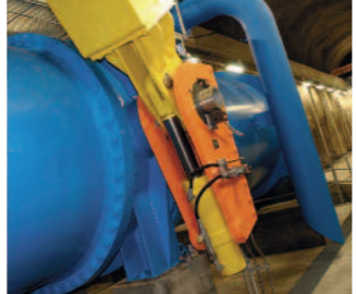
Drosselklappe in der Apparatkammer Tinizong.
