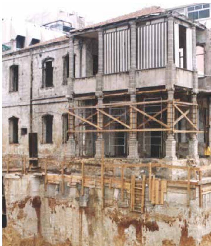
מבט לחזית המערבית בזמן עבודות חפירת המרתפים ו"תליית" המבנה ההיסטורי. צילום: איתמר גרינברג, 1996
