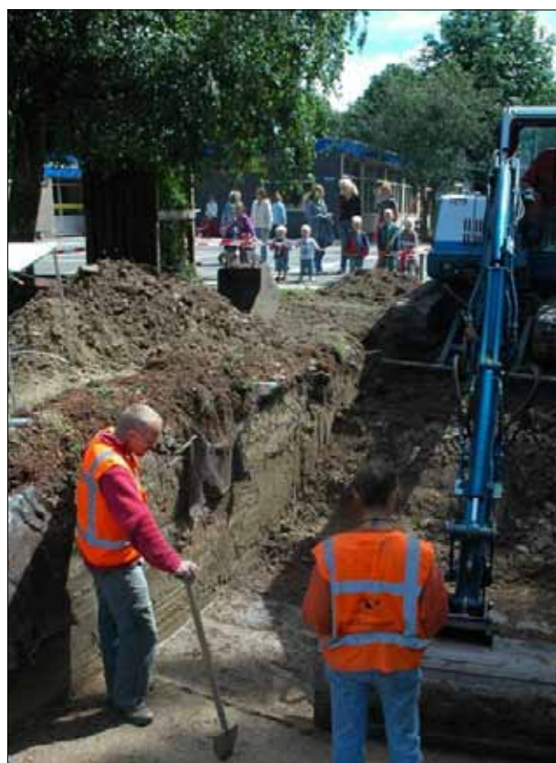
Afb. 5.3 Archeologisch onderzoek naar de limesweg op het schoolplein van de basisschool Drie Koningen in De Meern (wnr 14).
