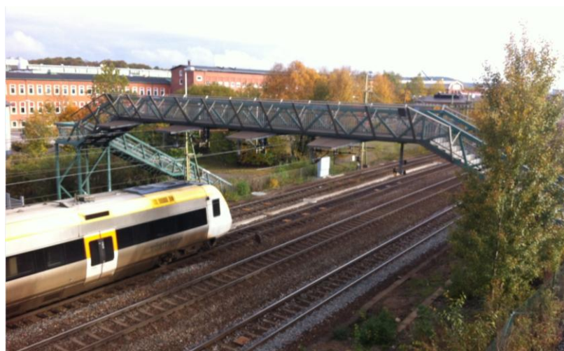
Befintlig gångbro över bangården som ska rivas och ersätts med ny bron.
