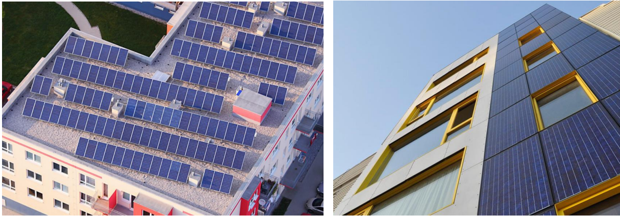
Joonis 7.7 Näide katusele paigaldatud (vasakul) ja fassaadile integreeritud (paremal) PV-paneelidest.
