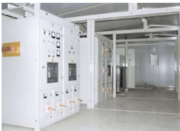
Размещение оборудования в блочно-модульном здании
