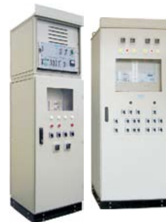
Устройства РЗА 110 кВ на базе блоков БЭМП (ШМЗТ, ШМРН, ШМДФЗ, ШМЗЛ, ШМЦС)
