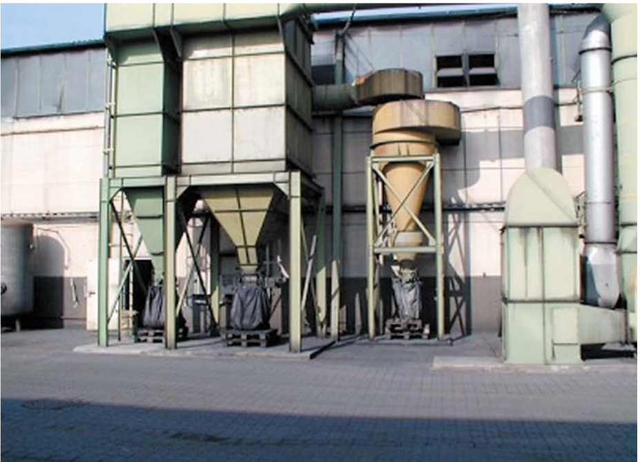
Bild 3-4: Filteranlage einer Buntmetallgießerei
