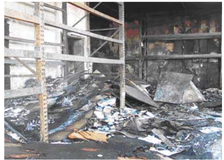
Bild 2-2: Kalte Brandstelle in einem Lager
