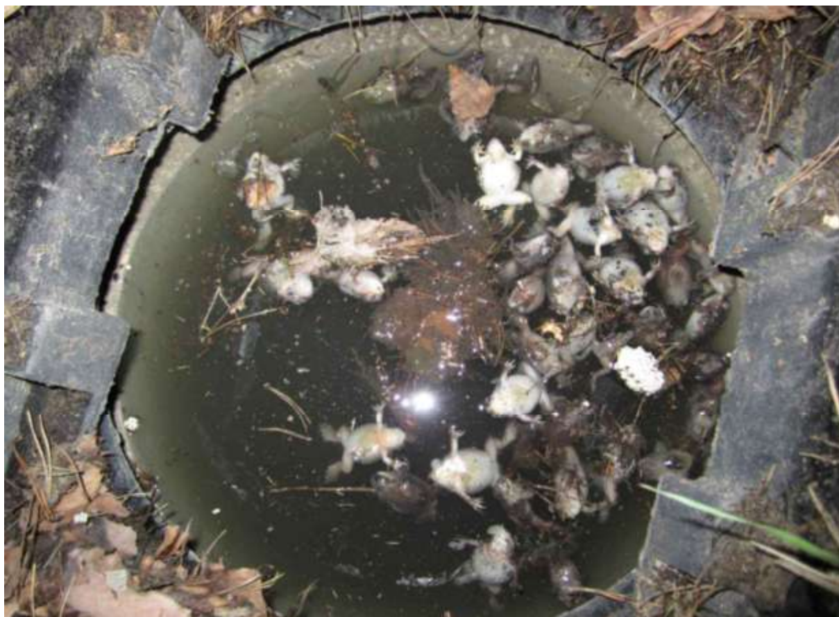
Fot. 121. Studzienka rewizyjna/ściekowa w ul. M. Grechuty wypełniona martwymi grzebiuszkami. (MM)
