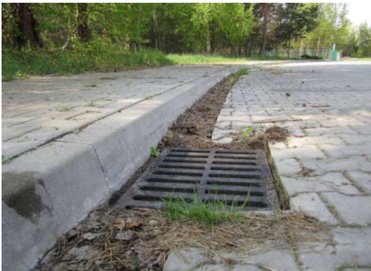
Fot. 230. Studzienka rewizyjna/ściekowa w ul. Grechuty. Wysoki krawężnik, uniemożliwia płazom opuszczenie kostkowej nawierzchni drogi i idealnie naprowadza płazy na studzienkę. (MM)
