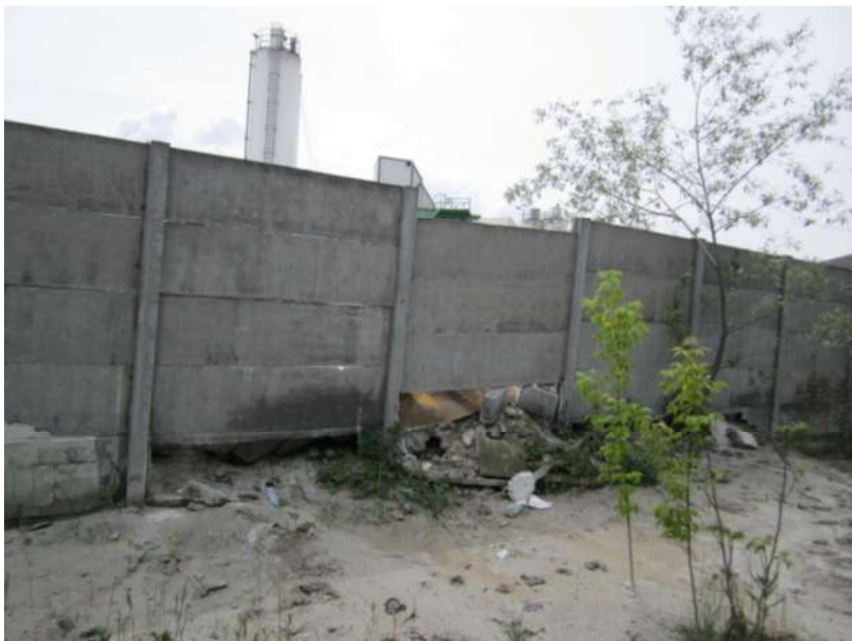
Fot. 224. Nieszczelne ogrodzenie zakładów przetwórstwa kruszywa i produkcji betonu. (MM)
