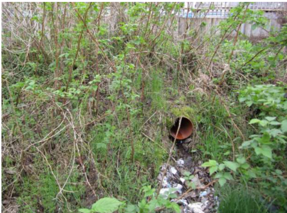
Fot. 253. Ujście rury PCV odprowadzającej wody z terenu zakładu produkcji kostki brukowej "JADAR". (MM)
