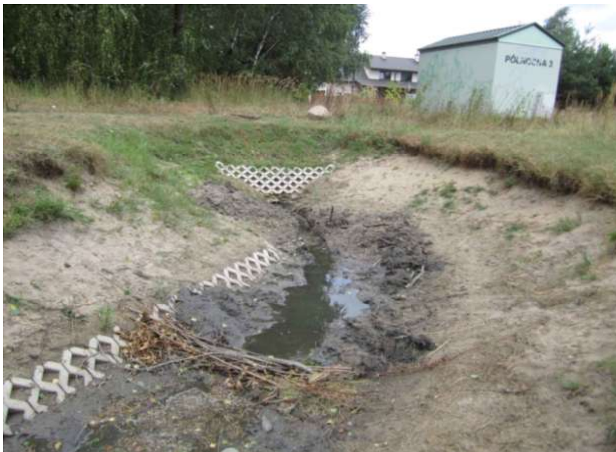
Fot. 236. Wysychający rów rozsączająco-odparowujący. (MM)
