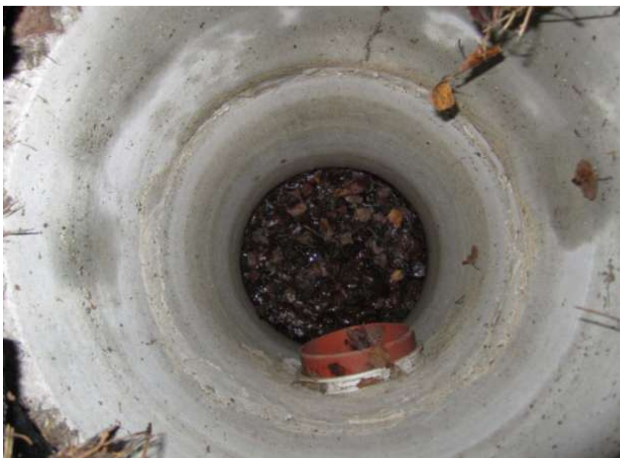
Fot. 232. Studzienka w ul. Grechuty podczas kontroli w dniu 14.11.2013 r. Na dnie widoczny szlam i liście skrywające setki grzebiuszek ziemnych, kumaków nizinnych oraz inne płazy. (MM)
