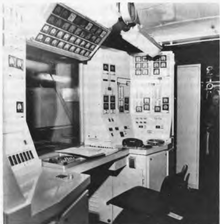
Fig. 3. Bedieningspaneel machinekamer controlepost. foto C. van der Meulen
